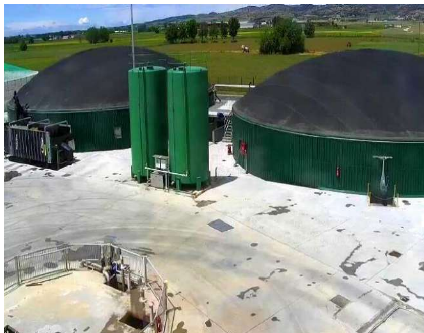
Εικόνα 3.3. Μονάδα παραγωγής βιοαερίου από ζωικά απόβλητα στο Λαγκαδά Θεσσαλονίκης 30
